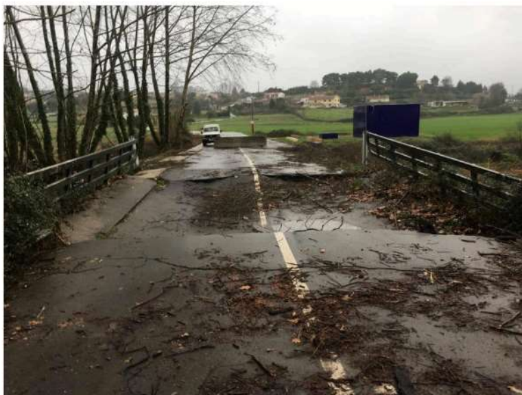
Figura 178 – Danos causados depressões Elsa e Fabien no Concelho de Albergaria-a-Velha, 2019 99
